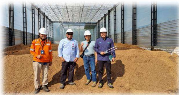
Fasilitas Blending dan Drying UV Jepara
